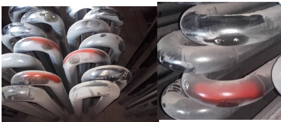
Obr. 2 Erozní opotřebení ložových hadů.
