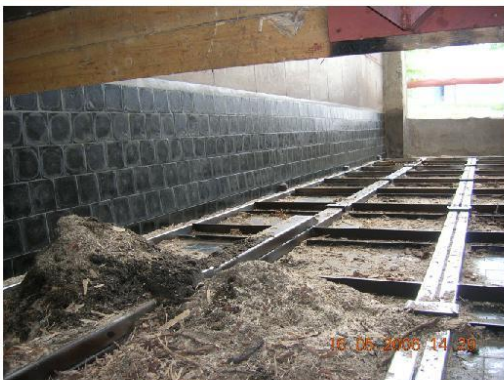
Zásobníky na dřevní štěpku - čedičový obklad
